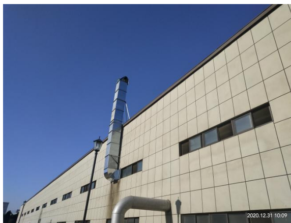
有机废气排气筒
