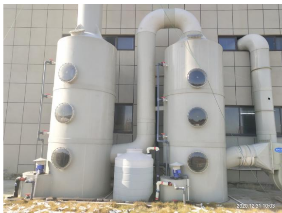
酸雾、碱雾处理设施
